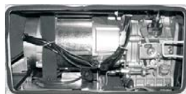
Passo 3. Localizzazione della batteria
